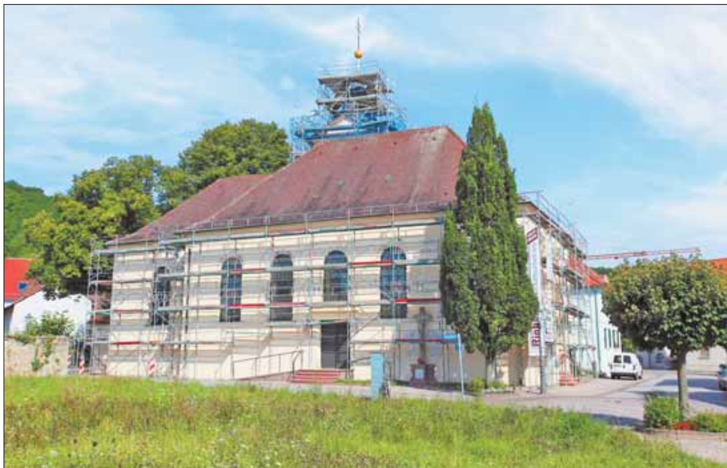
Eigentlich hätten die Arbeiten an Turm und Außenfassade der St.-Nikolaus-Kirche in Rotenberg schon im Juni abgeschlossen sein sollen. Weil während der Arbeiten jedoch unerwartete Schäden am Gebäude entdeckt wurden, dauert die Sanierung länger. Foto: Jan A. Pfeifer
